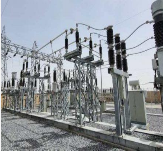
ایستگاه برق فوق توزیع خورق
